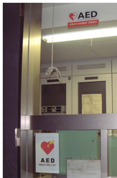
警備員室のAED設置表示
